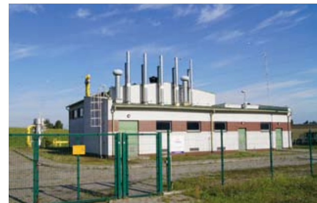
Stacja redukcyjna gazu na terenie ECZG Natural gas pressure reducing station in ECZG
